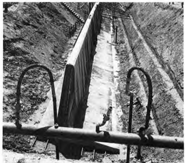
Abb. 11. Erstellung der Stützmauer in der Siltzone im Schutze der Wellpoint-Grundwasserabsenkung (vorn und rechts oben Anlage sichtbar)
